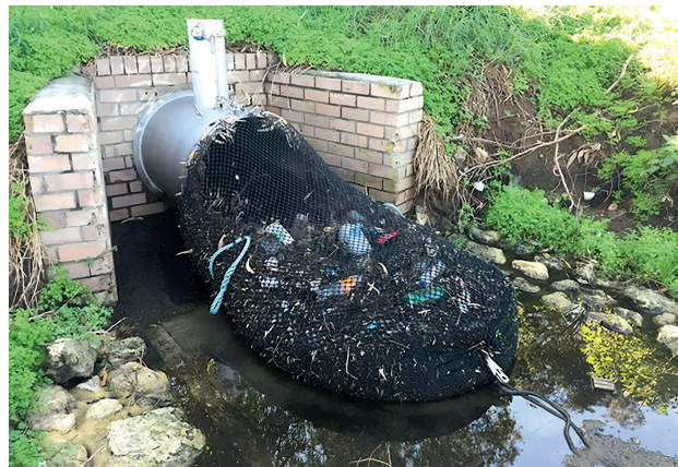
Figura 3: Red para el alcantarillado llena de contaminación del río
